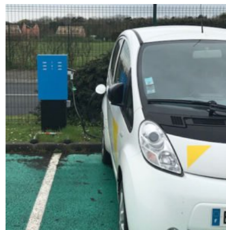
Borne de recharges véhicules électriques
